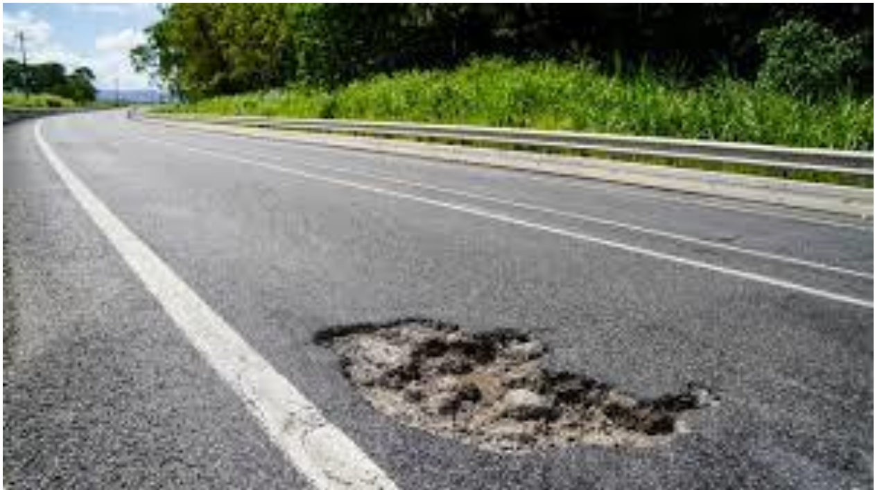
Рисунок-1. Разрушение структурных слоев дорожных покрытий
