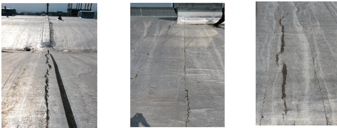
Рис.1. Фрагменты технически аварийного состояния ограждающего слоя кровли
