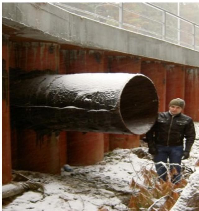
Рис.3. Водопропускная труба на расстоянии 155 см от днища лога
