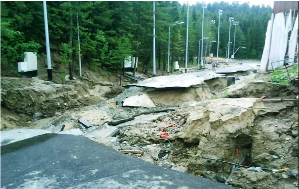
Рис.1. Разрушение полотна биатлонной трассы
