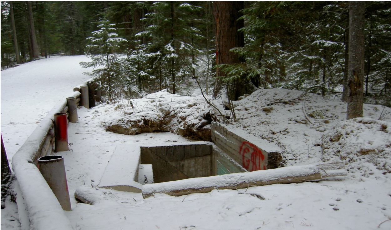
Рис. 2. Водопрпускное сооружение построено рядом с логом и не пропускает воду
